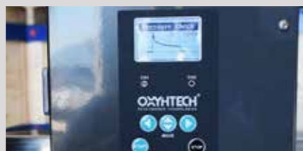
Controllo dello stato filtro / controllo della pressione differenziale
